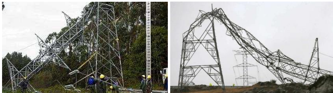
[Imaxe 3]. - Efectos dos temporais en Galicia: torre de media e alta tensión derribadas en xaneiro de 2009 polo ciclón “Klaus” en Sada (esquerda) e en febreiro de 2017 en Silleda (dereita).
